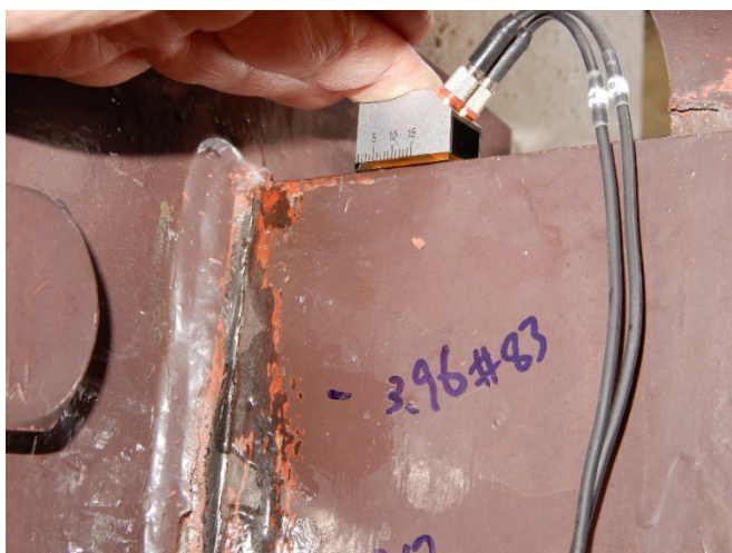
【写真 7】 小口から探傷する事が出来た
