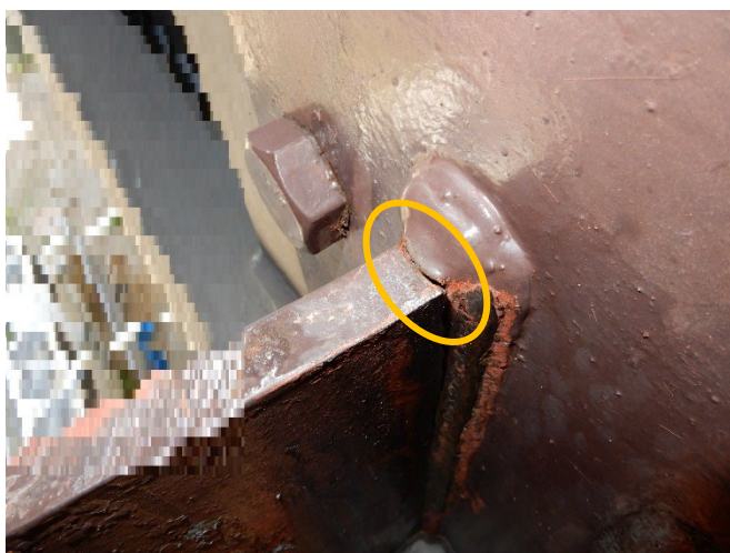
【写真 6】 ガセットプレート小口 危険なき裂
