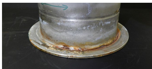
【写真2】エルボ側フランジ 外面
