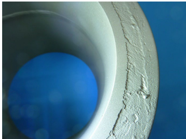
【写真5】エルボ側フランジ ブラスト後 ガスケット当り面に腐食が発生 配管内面には腐食は見られない
