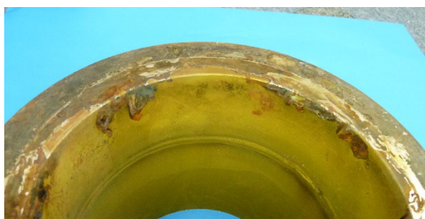
【写真3】直管側フランジ 内面
