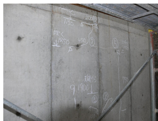
本体壁水平方向ひび割れ
