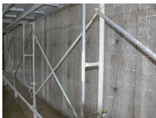
本体壁鉛直方向ひび割れ
